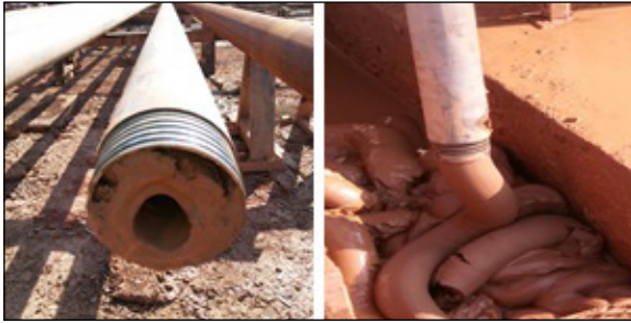
Şekil 5- Boru içi oluşan kekleşme ve boru içinin temizlenmesi sırasında ortaya çıkan kekleşme oranı.
